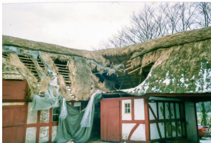
Stormen i 1999 ødelagde fuldstændig det gamle stråtag. (privatfoto)
